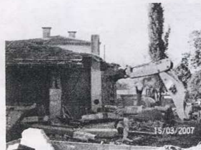
La pelleteuse œuvre pour faire place aux futurs sanitaires Garçons/Filles séparés avec accès handicapés
